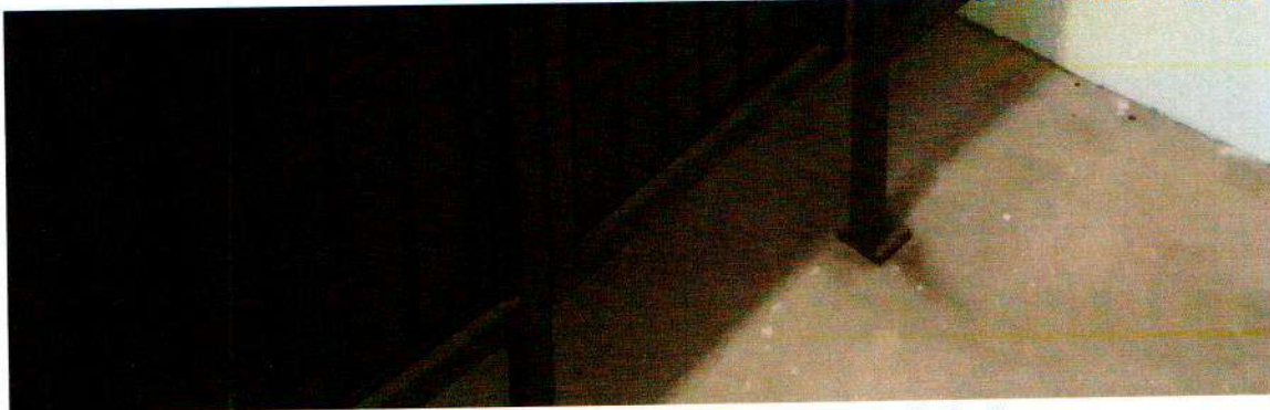
En estas fotografías se muestra la firme de concreto en área de baños.
