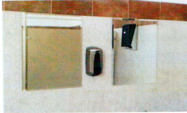
En esta fotografía se muestra la jabonera en área de baños
