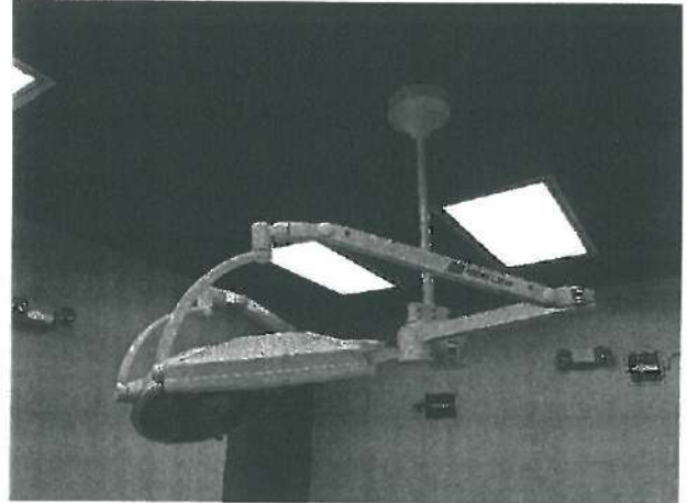
Lámparas dobles de quirófano
