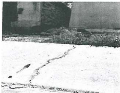
Grieta en Banqueta, ubicada en calle Allende y casi esquina con Calle Guerrero.
