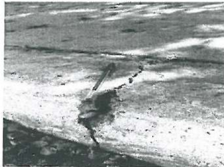
Grieta en Guarnición, ubicada en calle allende y casi esquina con Calle Guerrero.
