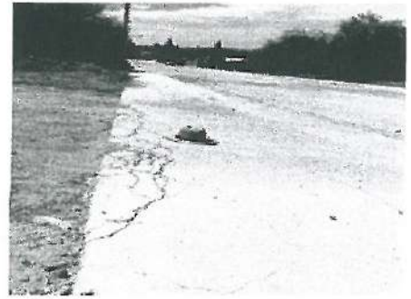
Daño en Banqueta de Concreto de dimensión de 4.00 x 1.20 mts, en la calle 21 de marzo entre Sexta y Kaly Mungaray.
