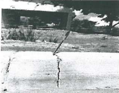
Grieta en Guarnición no.1
