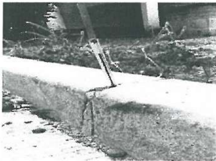
Grieta en Guarnición, en la esquina de las calles Brea y Sin Nombre.
