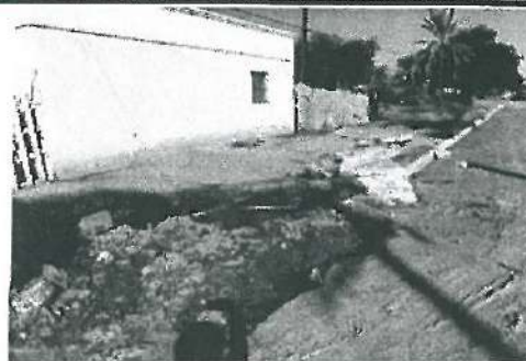
Falta de 6 Metros de Guarnición tipo "I" de Concreto Fc=150 kg/cm2 de 110 l/m, Arrojando un Monto faltante en Obra de $2,393.4 S/IVA
