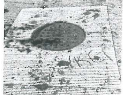
Daño en Losa por letras plasmadas
