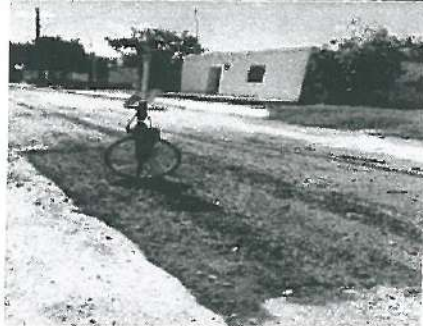
Bache de dimencion de 2.0 x 1.00 mts en calle Pipila entre calle Nicolas Bravo y la calle Allende.
