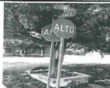
Se encontro señalamiento restrictiva (alto sr-6) de 61x61 cm. en el cual se empalma con con señalamiento del Municipio, ubicada en calle allende y esquina con Guerrero.
