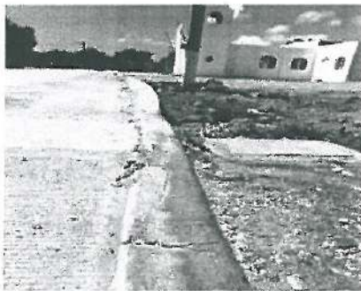
Grieta en Guarnición no.3
