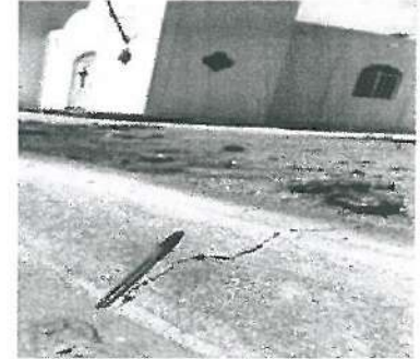
Grieta en Guarnición no.5
