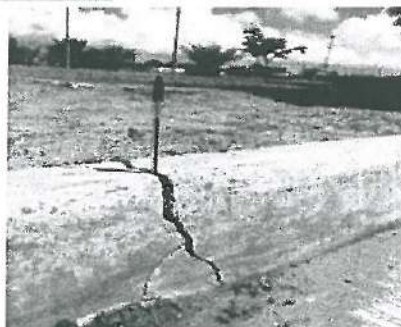
Grieta en Guarnición, ubicada en calle Sin Nombre.
