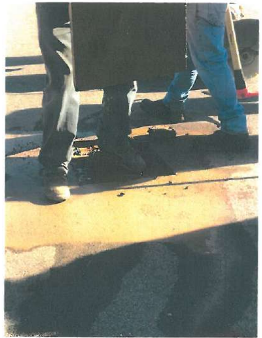
BACHE EN EL KM 3+531
