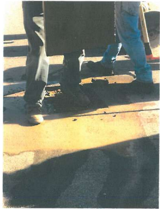
BACHE EN EL KM 3+531
