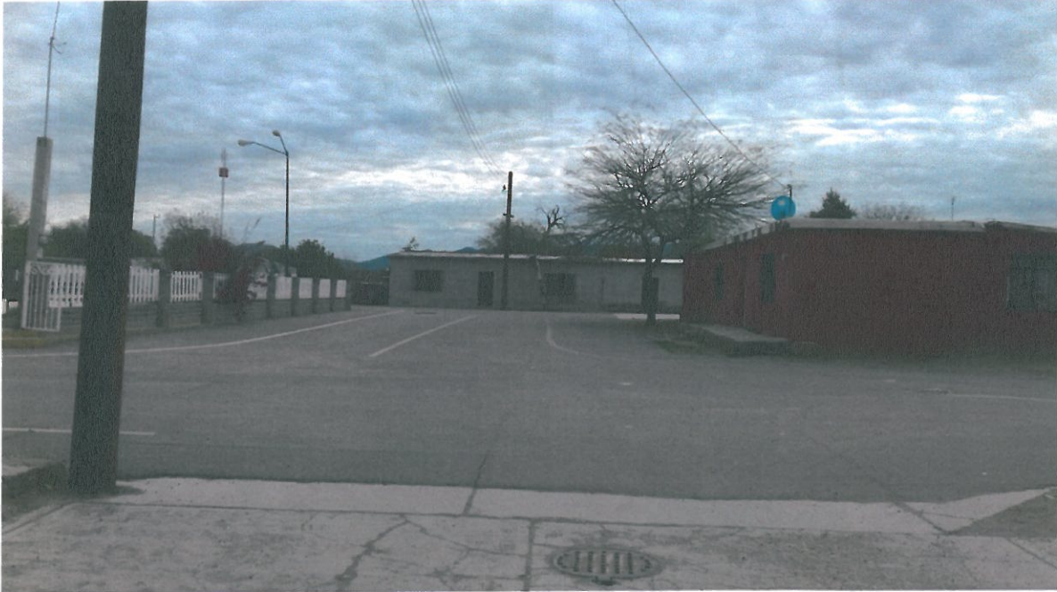
CALLE PLAZA SUR, SE APRECIA CARPETA ASFALTICA Y ALINEAMIENTO HORIZONTAL (RAYA BLANCA Y AMARILLAS).
