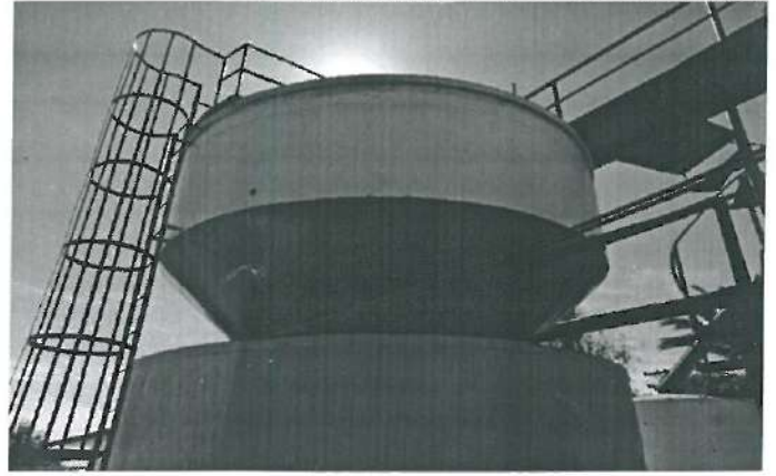
tanque metalico elevado
