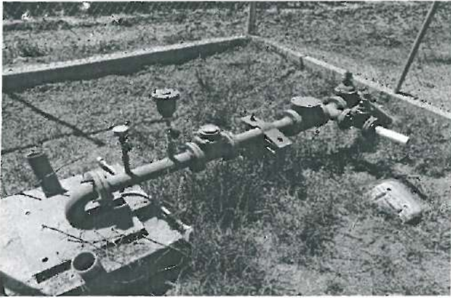
Valvulas para planta generadora
