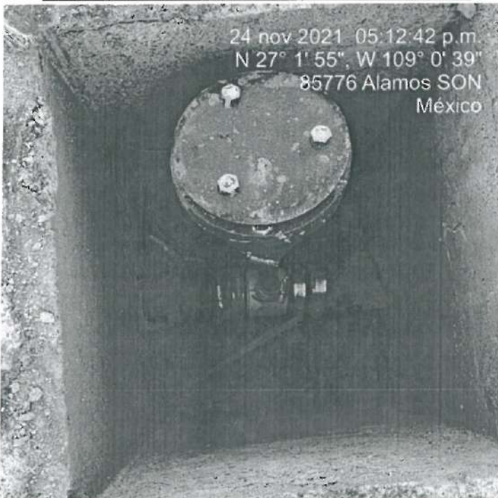
VISTA DE VÁLVULA DE ADMISIÓN Y EXPULSIÓN DE AIRE
