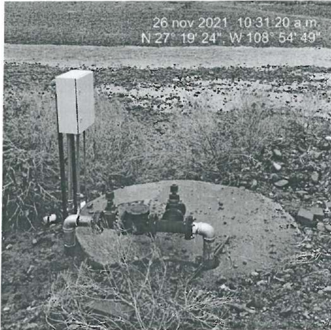
VISTA DE BOMBA DE EXTRACCIÓN
