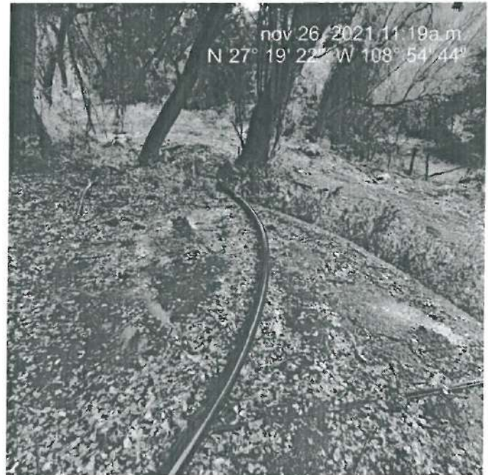
VISTA DE TUBERÍA DE RED DE DISTRIBUCIÓN
