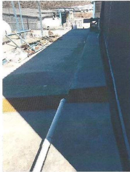
Corte y demolición a mano firme de concreto de 10 cm de espesor.
