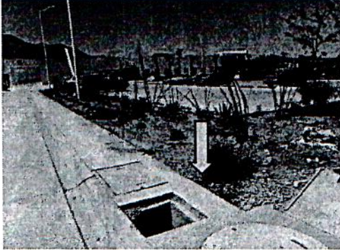
Hallazgo no. 5 Falta Tapa de Registro de Concreto de Voz y Datos en Banqueta en la Entrada del Acceso de Ambulancia.
