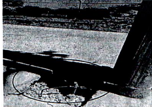
Hallazgo no. 6 Trabajos Inconclusos por la Falta Concreto en Banqueta, por la colocación de varilla para tierra de Poste de C.F.E.
