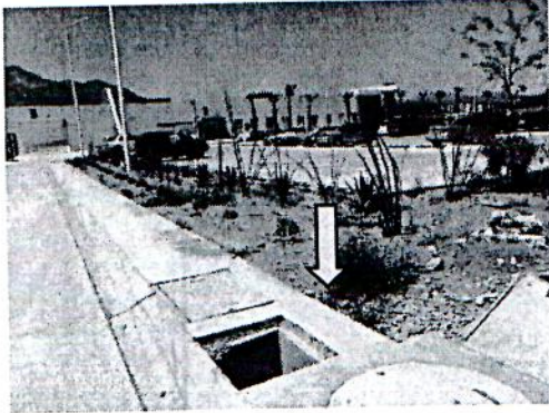
Hallazgo no. 5 Falta Tapa de Registro de Concreto de Voz y Datos en Banqueta en la Entrada del Acceso de Ambulancia.
