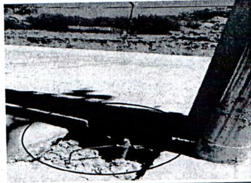
Hallazgo no. 6 Trabajos Inconclusos por la Falta Concreto en Banqueta, por la colocación de varilla para tierra de Poste de C.F.E.
