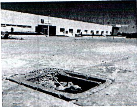
Hallazgo no. 1 Falta de 1 Tapa Registro Eléctrico en Área de Estacionamiento.
