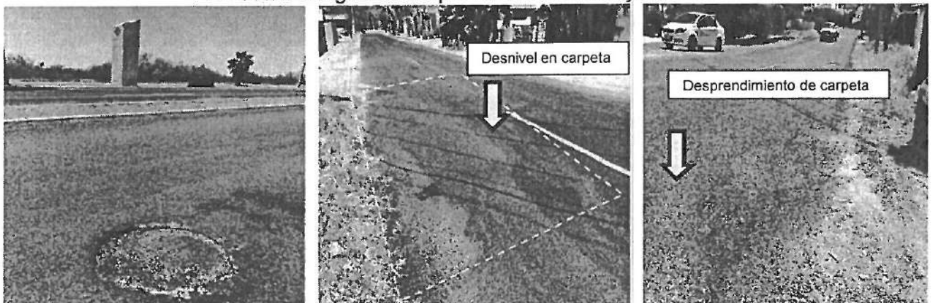
En estas fotografías se aprecia la falta de renivelación de pozo de visita (Ubicado en Km, no.7, en el Blvd. Manlio Fabio Beltrones Rivera)
