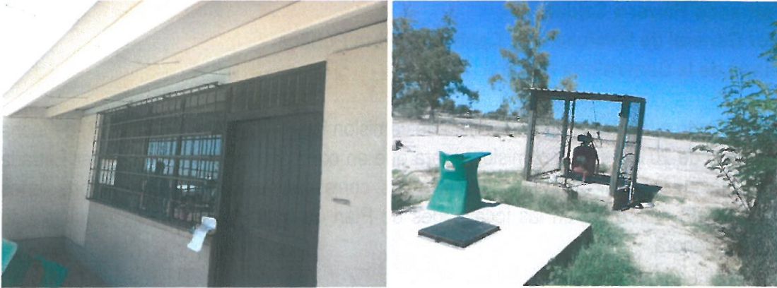
En estas fotografías se aprecian puertas, equipo hidroneumático y cisterna.
