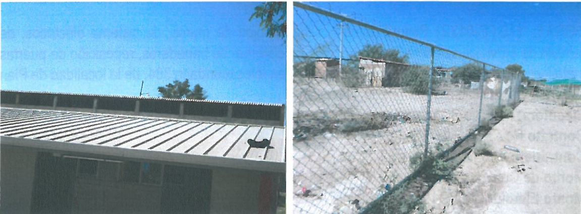
En estas fotografías se aprecian cubierta de panel y cerco de malla ciclónica
