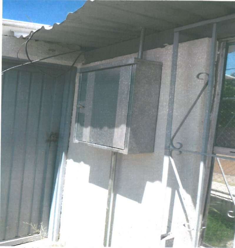
Gabinete, centro de carga y conducción eléctrica.
