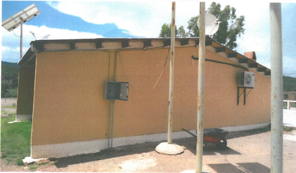
Centro de carga y suministro y colocación de mini-split.
